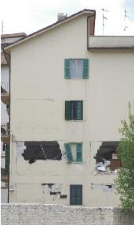
Edifici lesionati in periferia de L'Aquila
