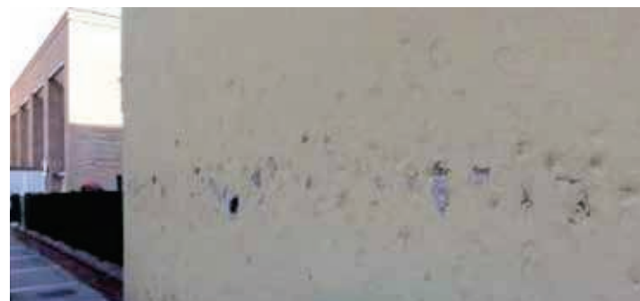
Isolamento a cappotto tradizionale danneggiato in superficie.
