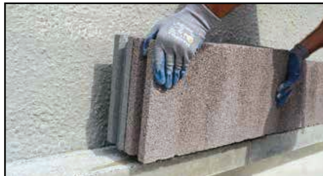
Posa del primo corso di MuroCappotto con Malta fluida o schiuma poliuretanica.
