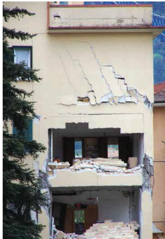
Pareti di tamponamento lesionate in seguito al sisma de L'Aquila del 2009.
