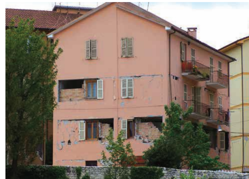
Edificio lesionato in seguito al sisma de L'Aquila del 2009.
