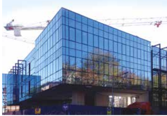
Nuova Sede Angelini a Roma - Lecablocco Tagliafuoco e Lecablocco Tramezza Lecalite - in corso di certificazione LEED.
