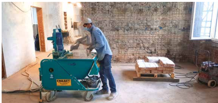
L'intonaco armato è realizzato con MX-CP Calce, malta strutturale a base di pura calce idraulica naturale NHL 3.5.
