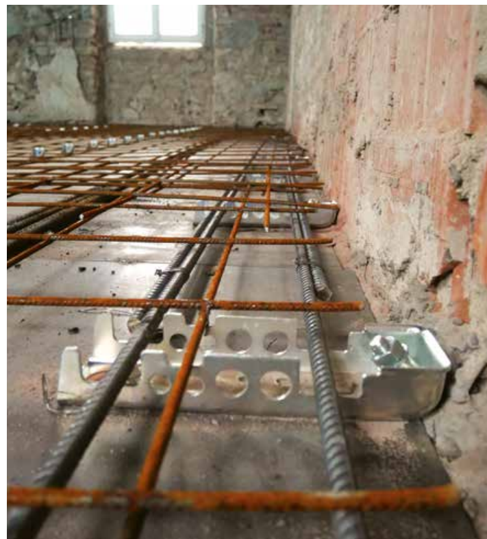
Dettaglio del sistema di consolidamento antisismico dei solai Perimetro Forte con Connettore Perimetrale e Ancorante Chimico per l'ancoraggio alle pareti e la realizzazione della cerchiatura perimetrale.
