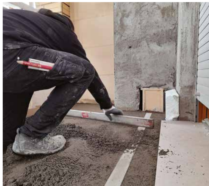
Massetto delle pendenze nei balconi del complesso residenziale, oggetto di riqualificazione energetica, con Super Sabbia e Cemento Fibrorinforzato Gras Calce.
