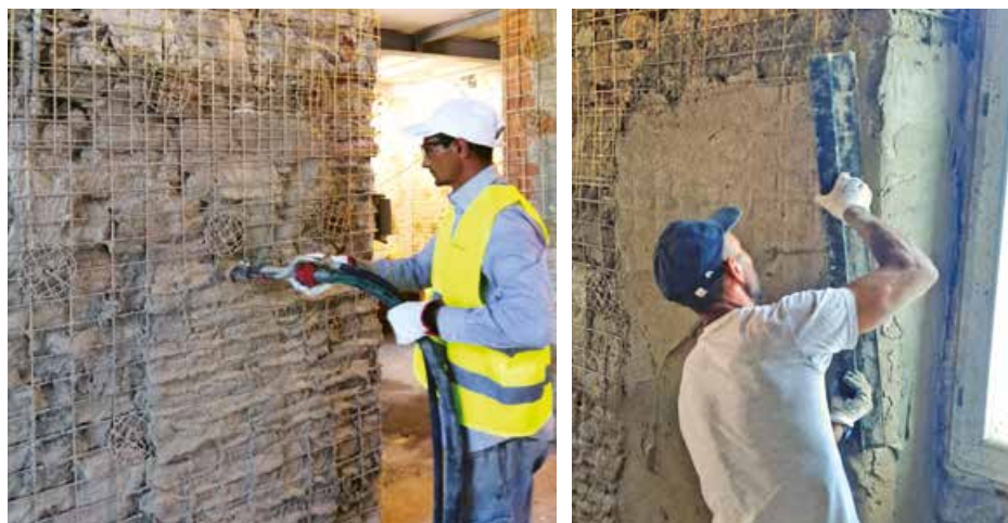
Stesura dell'Intonaco Armato CRM in MX-CP Calce con macchina intonacatrice in seguito alla posa della rete preformata GFRP G-Mesh 400 Ruregold.
