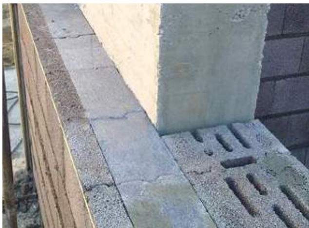
Parete di tamponamento con Lecablocco Bioclima Zero18P (setti in c.a. di spessore 25 cm).
