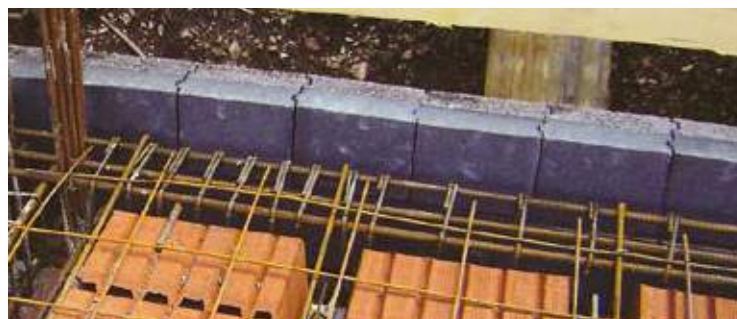
Parete di tamponamento in Lecablocco Bioclima Zero18P (pilastri in c.a. di spessore 30 cm) - Tavella Isolata in corrispondenza del cordolo di solaio.
