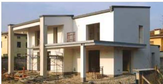
Edificio residenziale in Lecablocco Bioclima Zero18P con struttura a telaio in calcestruzzo di spessore 30 cm.
