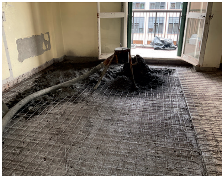
Posa della soletta collaborante in LecaCLS 1400 CAM dopo la stesura del Connettore Chimico CentroStorico.
