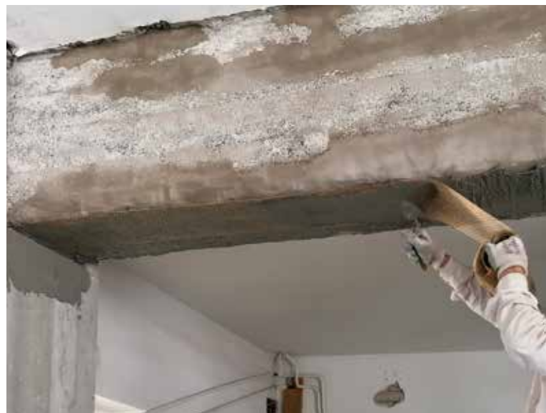
Rinforzo a flessione: posa della matrice inorganica MX-PBO Calcestruzzo e rete PBO-MESH lungo la direzione dei ferri longitudinali.
