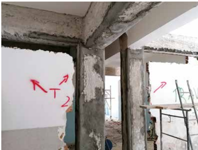
Preparazione del substrato: asportazione del calcestruzzo ammalorato, pulizia dei ferri e applicazione del PASSIVANTE. Ripristino del calcestruzzo (copriferro) mediante malta MX-R4 Ripristino.
