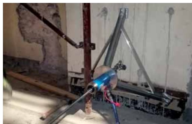
Prove di cantierabilità del sistema Perimetro Forte: Sistema treppiede per prove di estrazione in situ.
