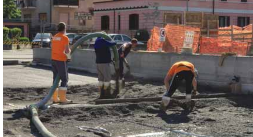
Fase di pompaggio dell'argilla espansa LecaPiù 2-3 cementata attraverso speciali autotreni cisternati. Il pompaggio può arrivare sino a 80-100 m di distanza in orizzontale.
