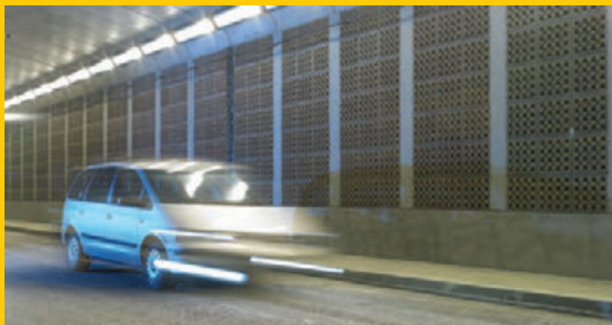
Rivestimento fonoassorbente in una galleria a Torino.
