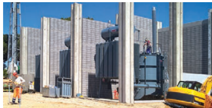
Bonifica acustica nella Stazione Terna di Roma.
